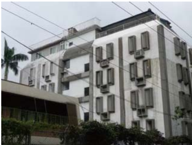
更新前建物立面老舊漏水（照片由老圍造園工程提供）
